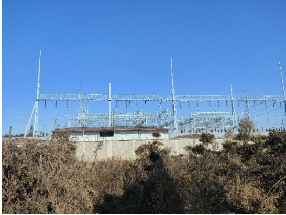
500kV 崇明变电站
