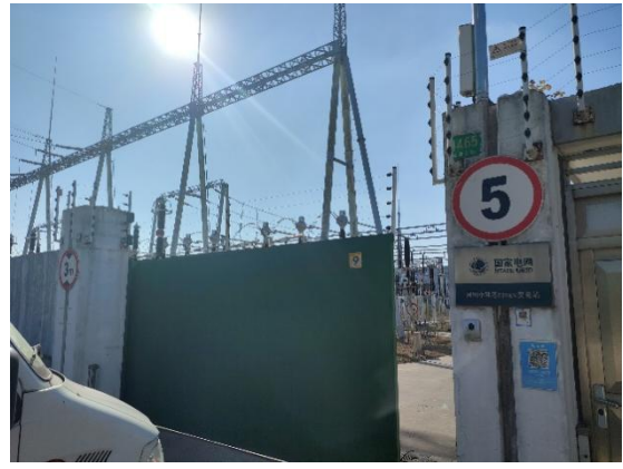
220kV 中双港变电站
